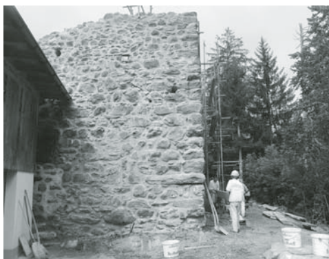
Die nun gesicherte Nordostecke von Strahlegg (Foto BVG)
